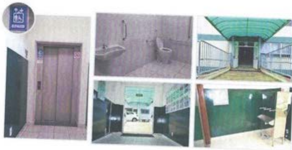
Figura: Acessibilidade elevador, banheiro para pessoas com deficiência, corrimão, rampa, bebedouro
